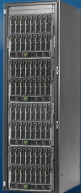
Internet Data Center
