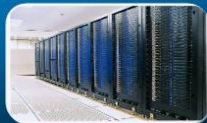
机架和数据中心
